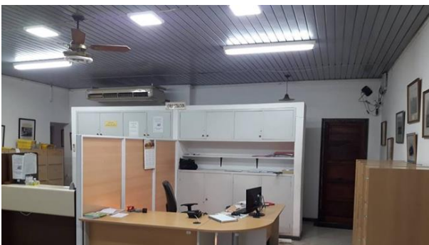
Atención al público antes de la renovación a LED
