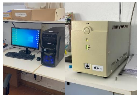
Servidor y UPS del proyecto - Fuente: visita técnica
