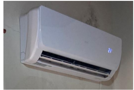
Equipo Mini Split utilizado para AA y calefacción (eléctrico) – Fuente: Visita
