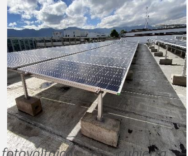
Paneles fotovoltaicos en cubierta Fuente proyectos acompañados TERA0
