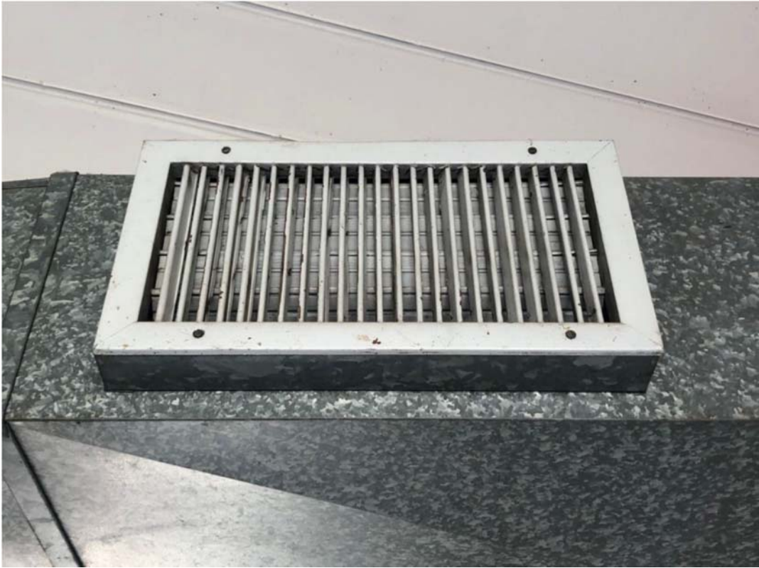
REJILLAS EN DUCTOS (1ER PISO) – REFERENCIAL
